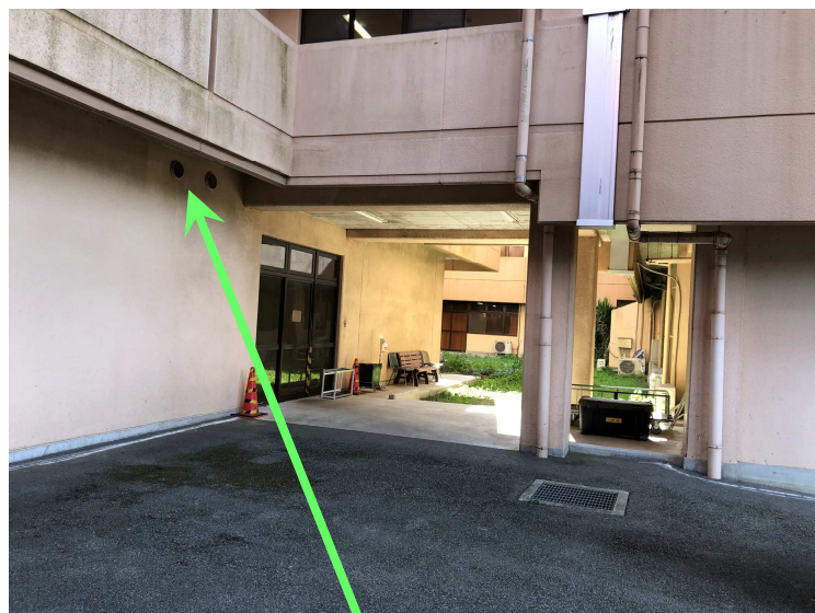
外部の外気取入口
