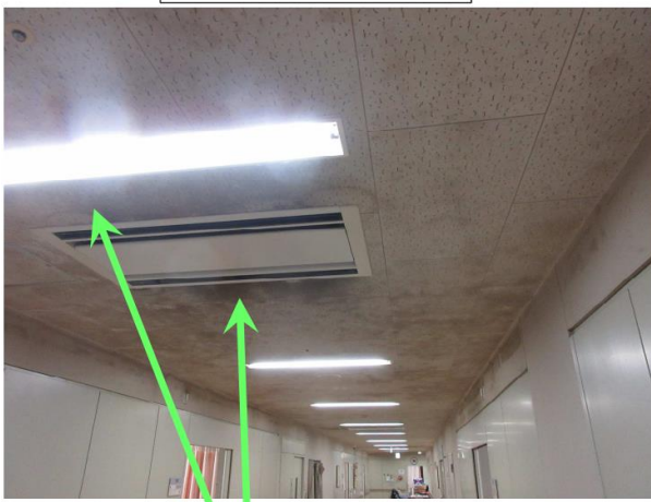
空調機吹出口周辺の天井にカビが発生
